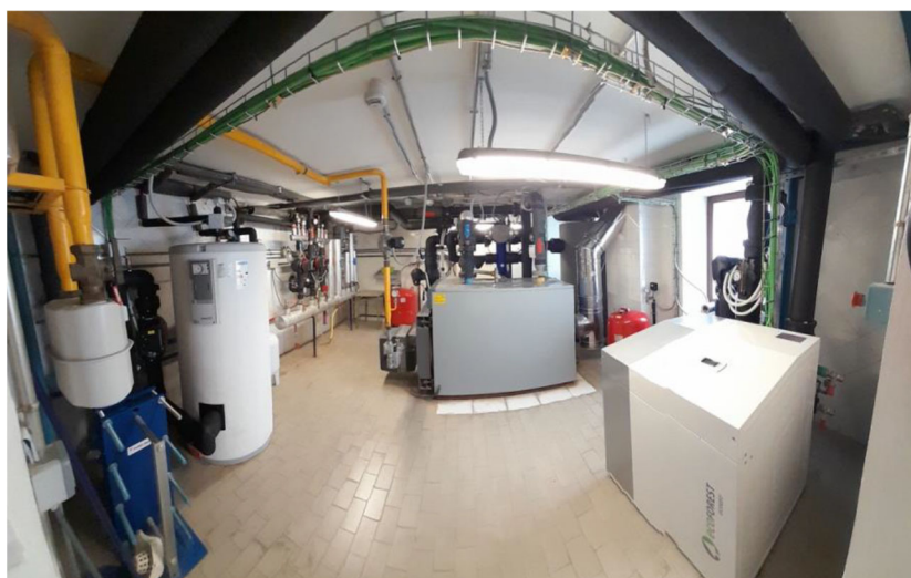
Sistema conjunto (Caldera y bomba de calor)
