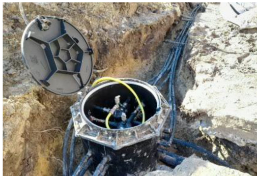
Arqueta de distribución
