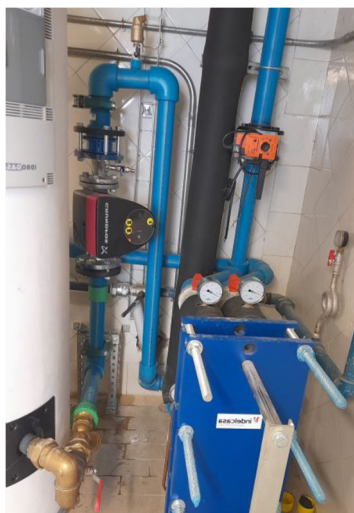
Intercambiador de placas (Circuito ACS)
