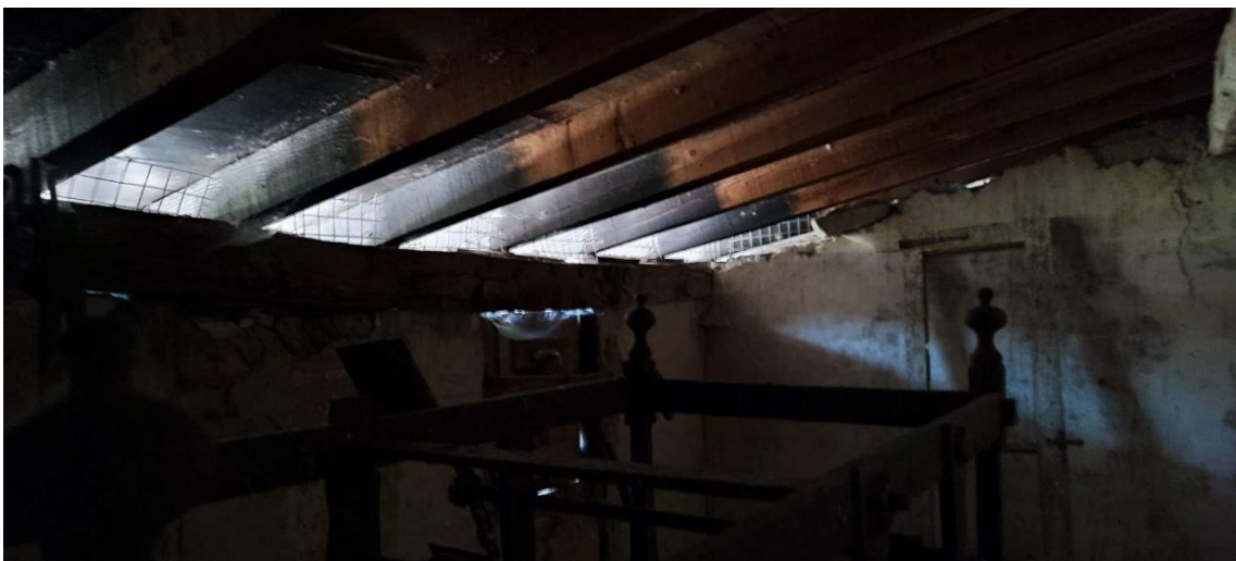
Figura 15. Iglesia de Estarrona. Arriba: detalle del guano encontrado. Centro y abajo: cierre de los accesos a la bóveda mediante malla metálica.
