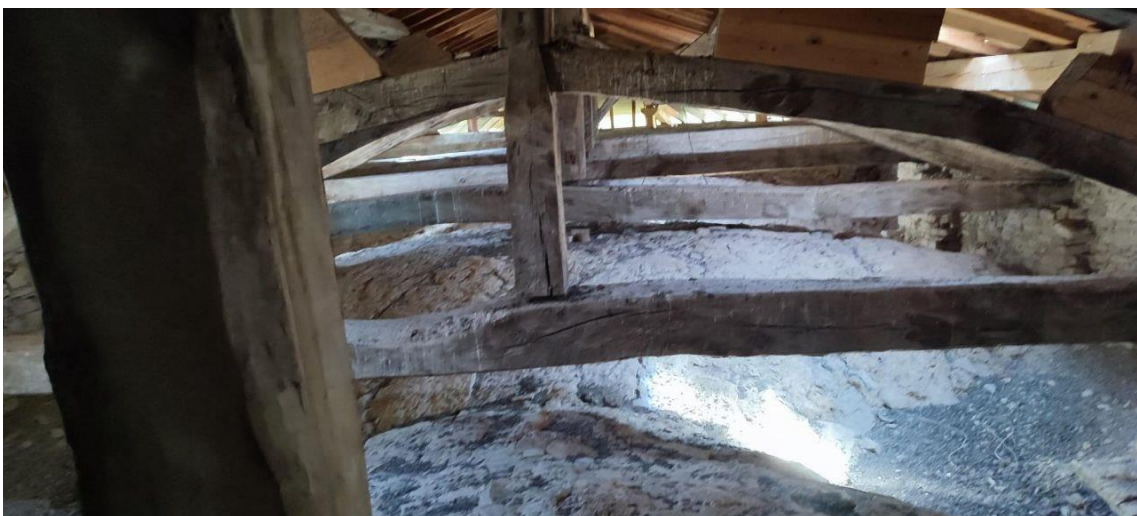
Figura 14. Bóveda de la iglesia de Estarrona. Se observan cúmulos antiguos de guano junto a las crucetas.
