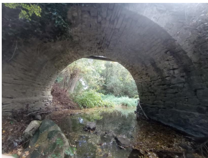
Figura 6. Uno de los ojos del puente sobre el río Zaia, junto al bosque de Estarraona. En las grietas en la parte superior se observó un murciélago ratonero ribereño, M. daubentonii .
