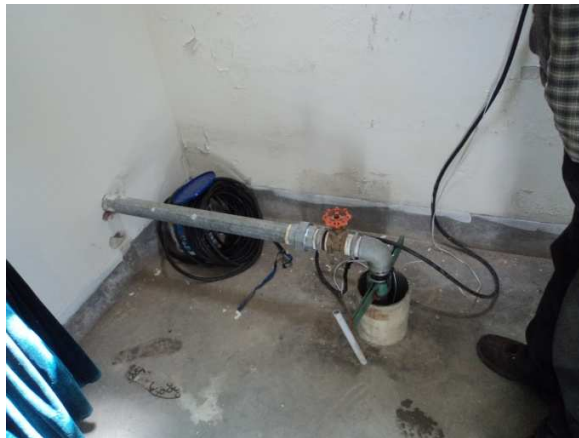
Fotografía N° 03: Tubería de impulsión. No tiene instalada la tapa protección, las válvulas de descarga, limpieza y retención y el manómetro para el control de presión.
