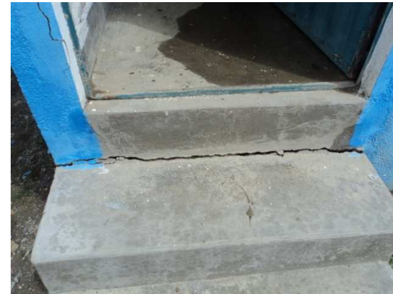
Fotografía N° 02: Peldaños de ingreso a la caseta de bombeo en mal estado
