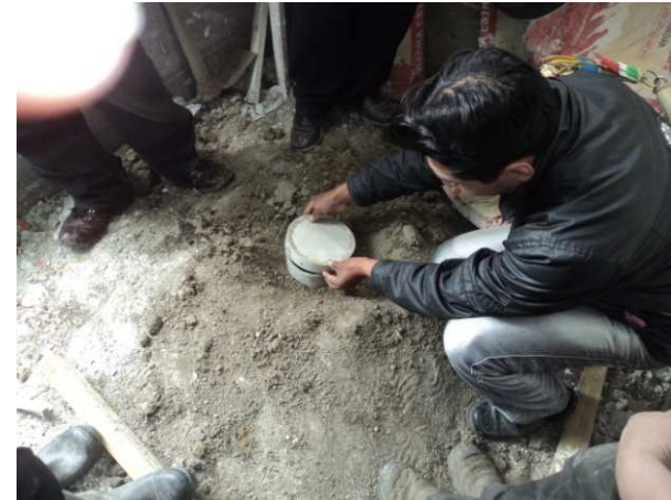
Fotografía N° 02: Retiro de la protección provisional del extremo superior de la tubería del pozo
