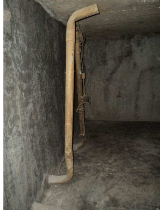
Fotografía N° 09: Tuberías de impulsión y rebose del reservorio deteriorados
