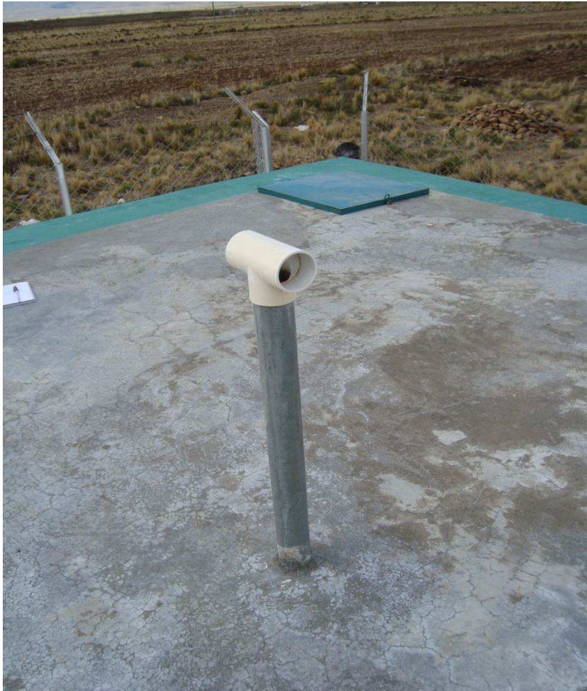
Fotografía N° 13: Tubería de ventilación del reservorio.
