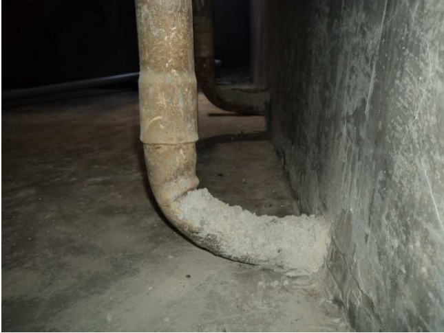
Fotografía N° 10: Tubería de rebose deteriorada
