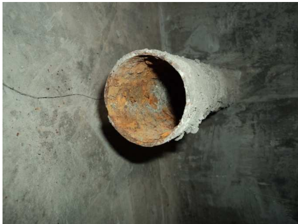
Fotografía N° 08: Tubería de salida del reservorio.
