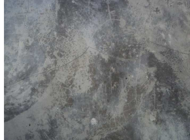
Fotografía N° 11: Rajaduras en la pared interior del reservorio
