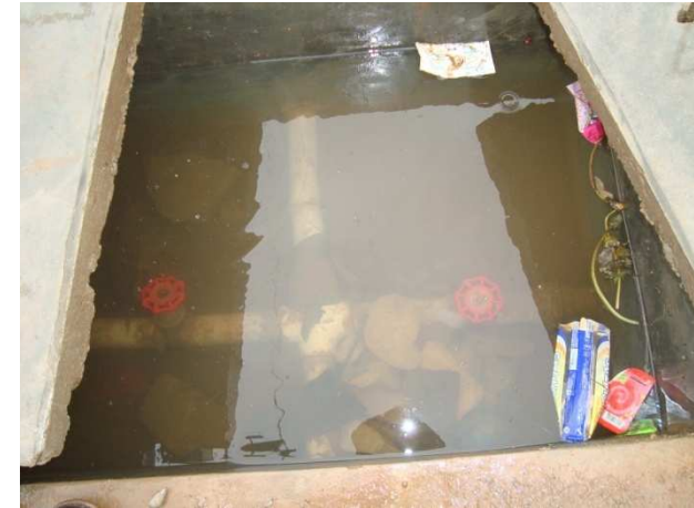
Fotografía N° 14: Válvula de control en la red de distribución inundada
