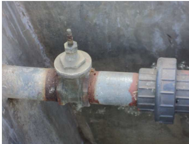
Fotografía N° 12: Válvula de control de salida del reservorio deteriorada
