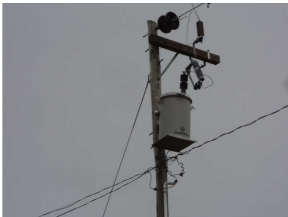
Fotografía N° 04: Transformador aéreo de 220 voltios instalado
