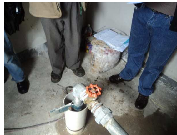
Fotografía N° 05: Tubería de impulsión. No tiene tapa protección, válvulas de descarga, limpieza y retención y el manómetro para el control de presión.
