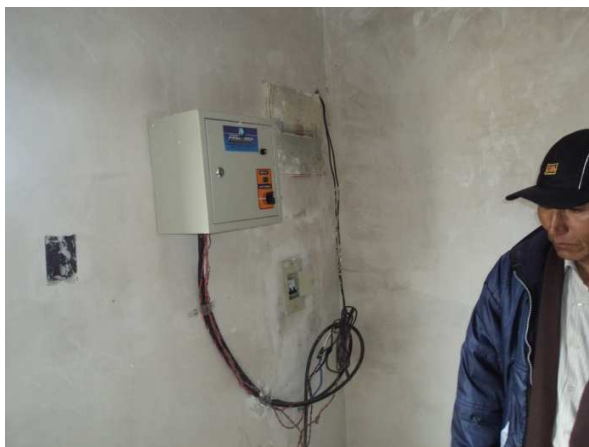
Fotografía N° 06: Tablero de control eléctrico con cables expuestos al aire libre y sin protección
