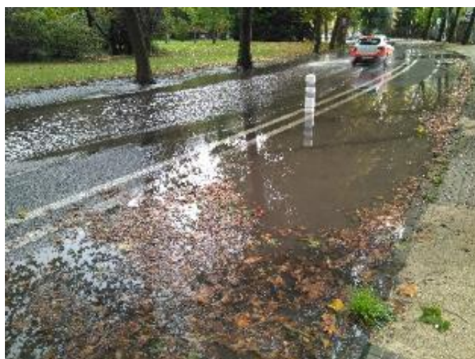
Ilustración 15. Deficiencias por inundación en el carril bici de plaza Gamarra
